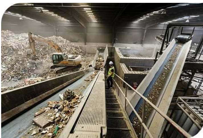
Sorteerinstallatie van KLOK Containers
